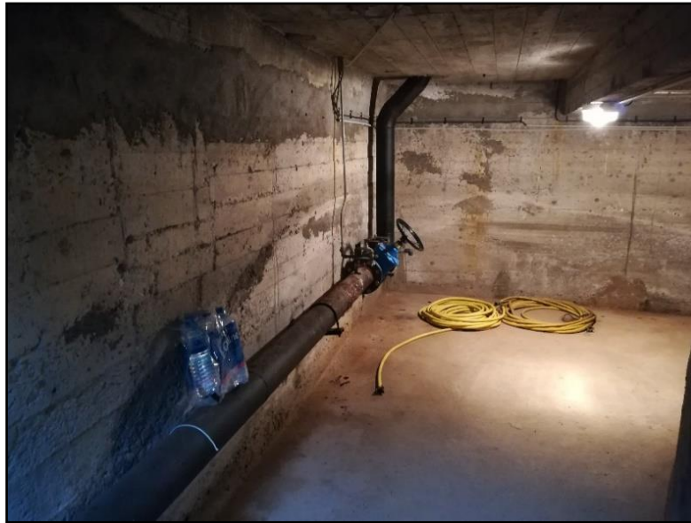
Figure 5 : Photographie de la conduite d'adduction vers le réservoir du Planas
