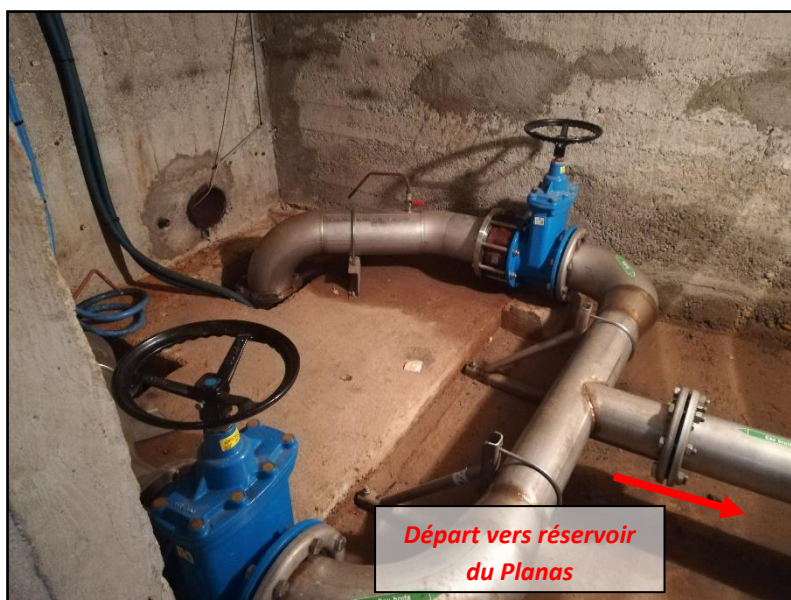
Figure 4 : Photographie de l'exhaure des 2 pompes
